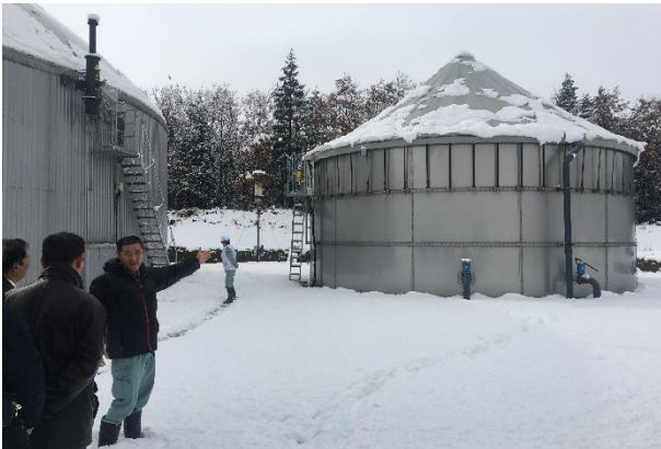
米の娘ファームのバイオガス発電施設
